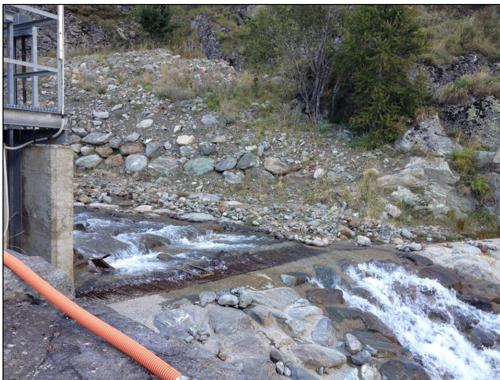
Foto 4: PRESA ESISTENTE SUL T. BERROVARD
